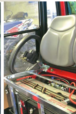
BUONA PROTEZIONE Il gruppo batterie è situato sotto protetto da un telaio in acciaio.
